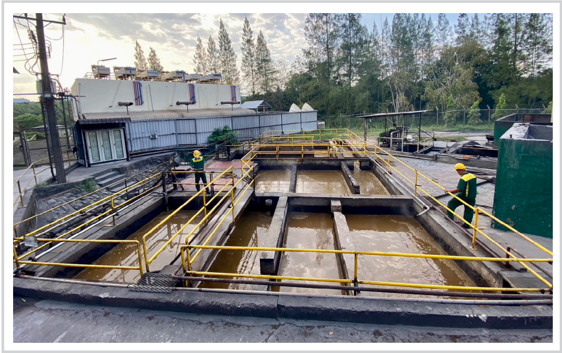
บ่อดักไขมันที่โรงงานปลายพระยา
